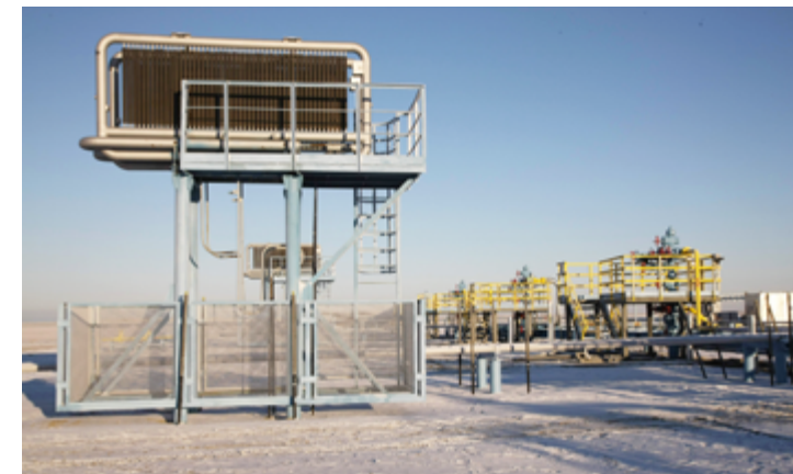
Внешний блок системы термостабилизации грунта на кусте скважин
