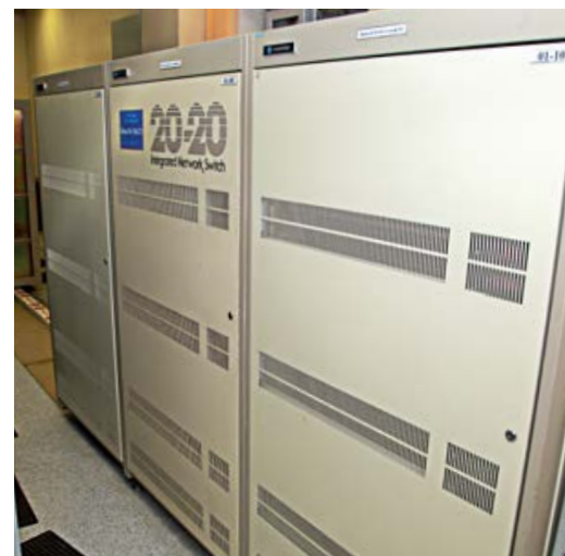
Устаревшая телефонная станция Harris 20-20 LH
