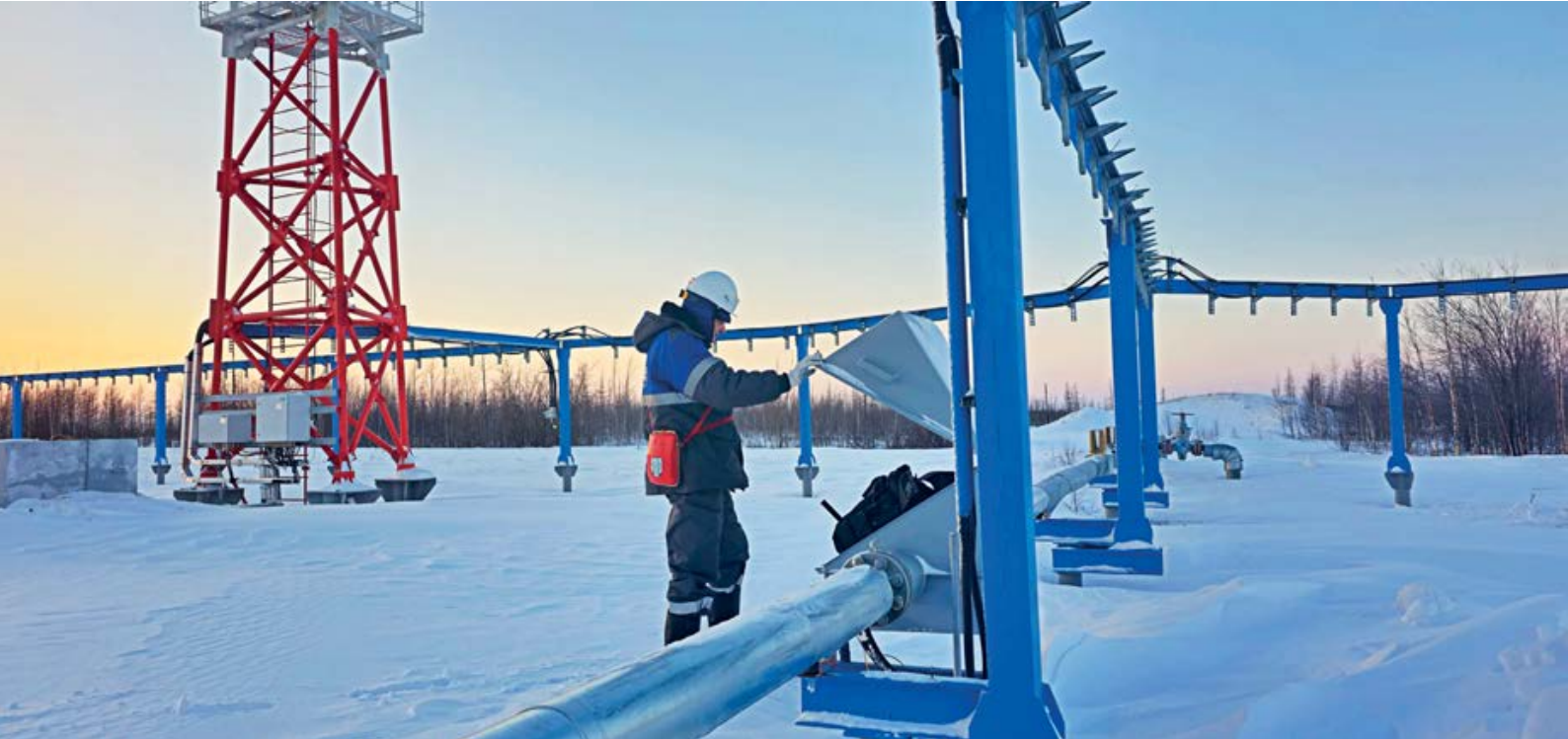
Обзор реконструированного оборудования на кусте газовых скважин Ямсовейского промысла
