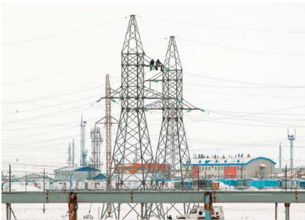
За рабочую смену электромонтёры обслуживают от двух до четырёх опор высоковольтных линий
