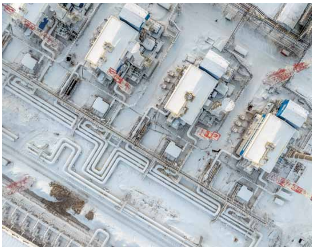
Завораживающая архитектура дожимной компрессорной станции Харасавэйского ГКМ
