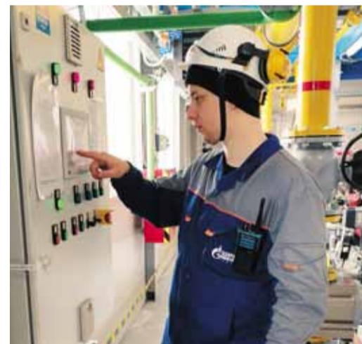
Слесарь-сантехник ЯГПУ Тимофей Хатыпов производит переключение насосов на щите управления котельной
