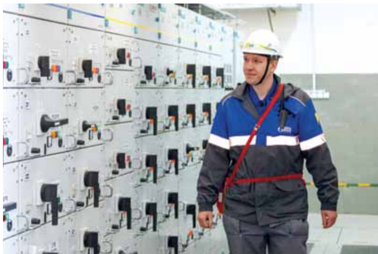
Контроль электроснабжения потребителей промысла на ДКС
