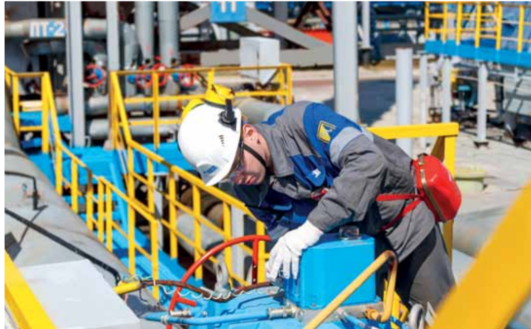
Наращивая свою газоперекачивающую мощность, предприятие даёт развитие энергомашиностроению России
