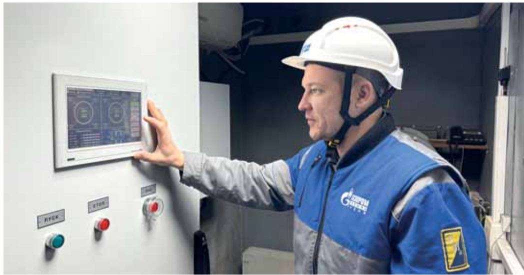
Юрий Ляховец, слесарь по КИПиА, контролирует работу системы управления электромагнитным подвесом
