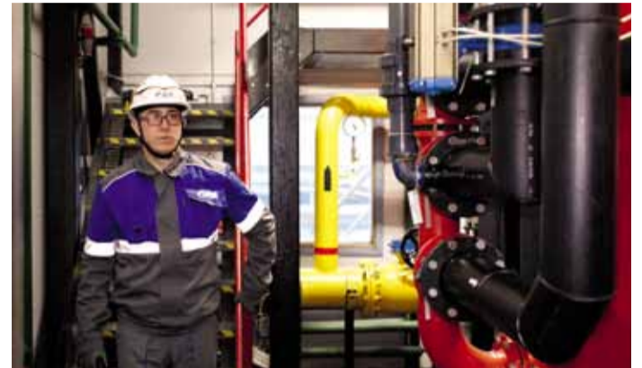
Сергей Ростовицков, оператор котельной, следит за состоянием оборудования
