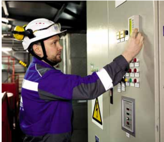
Фазыл Ханипов, оператор котельной, во время визуального осмотра котла
