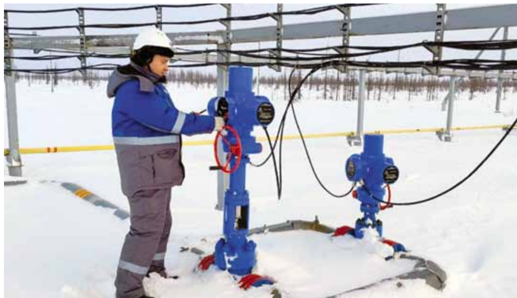
Денис Остапенко, оператор по добыче нефти и газа, контролирует перестановку электроприводов
