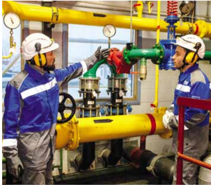
Слесари Альфред Гильманов и Александр Мазуров на обходе котельной
