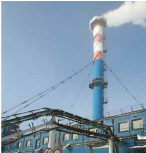
Котельная «Сермет» на Бованенковском месторождении
