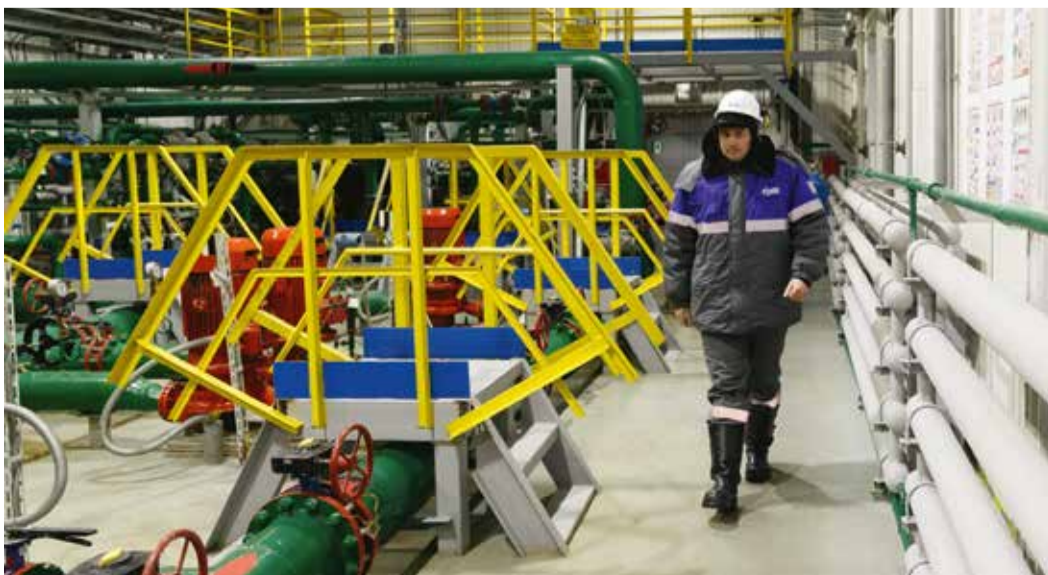
На насосной станции хозяйственно-питьевого и противопожарного водоснабжения
